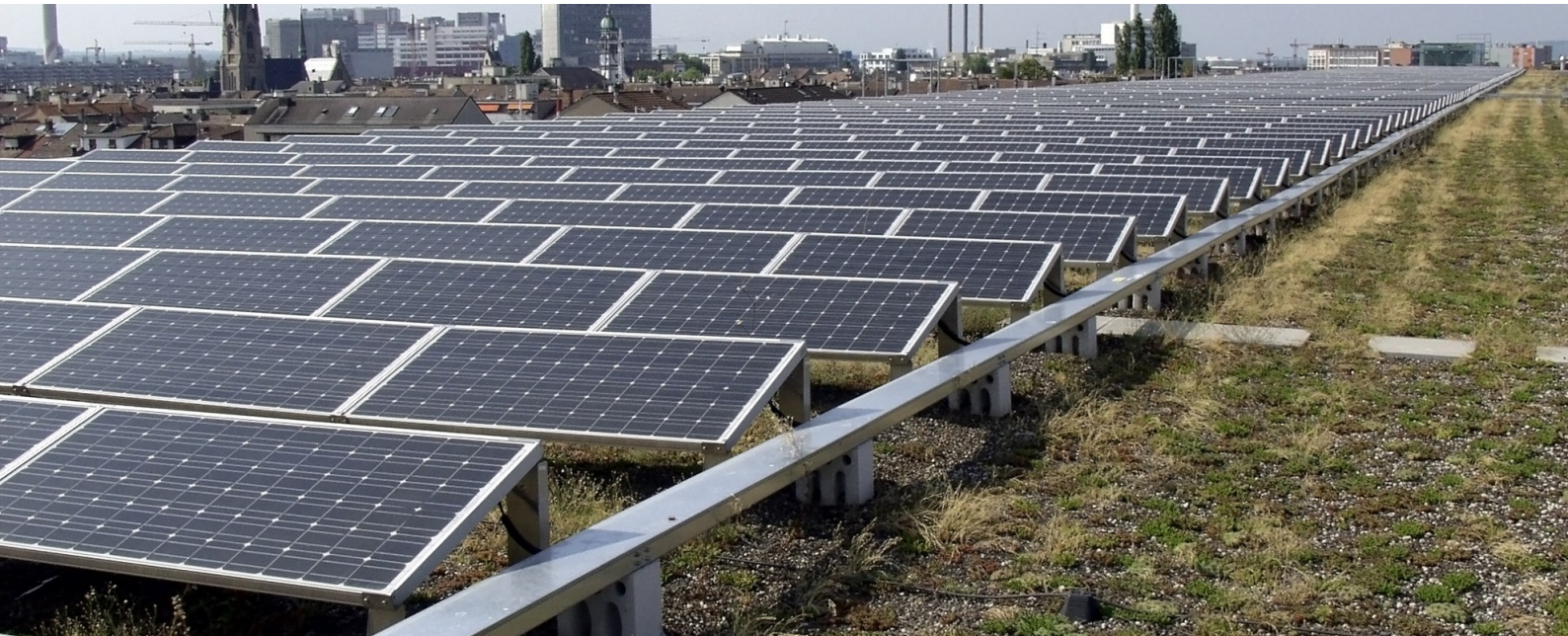
Photovoltaik-Anlage auf dem Dach der Messe Basel
